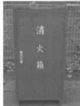
初期消火箱 (固定式)
